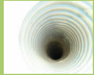
Abluftleitung nach Reinigung
