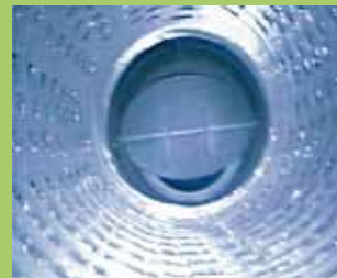
Abluftleitung nach Reinigung
